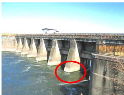
水門橋脚下洗掘部空隙
