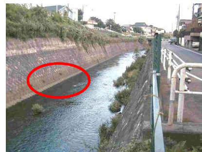
河川護岸背面空隙
