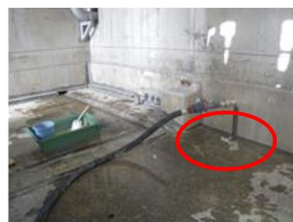
構造物基礎スラブ下空隙
