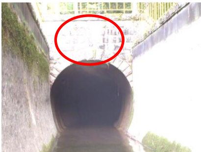
水路トンネル背面空洞
