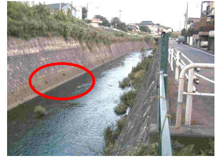
河川護岸背面空洞
