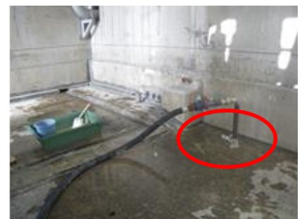
構造物基礎スラブ下空隙
