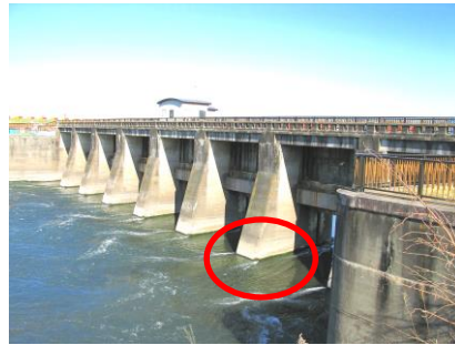
水門橋脚下洗掘部空洞
